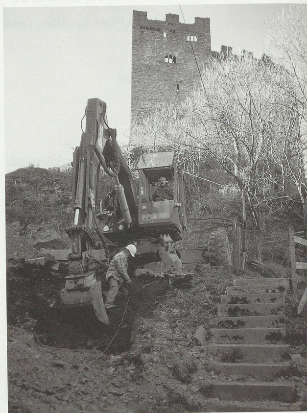
Abb. 3. Wartau, Gretschins. Bau einer Kanalisationsleitung unterhalb der Burg Wartau. Foto KA SG.
