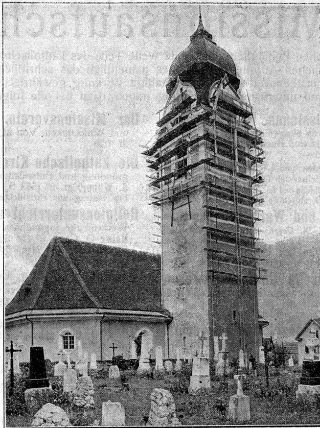
Turm-Gerüst, System „Blitz“ (für Uhr und Verputz-Reparaturen)
