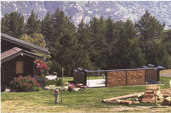
Vermutete illegal betonierte Plattform an einer umgebauten Hütte im Wallis
