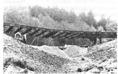
Durch eine Sprengung wurde auch der ganze Unterbau einer Bahnlinie weggefegt.
