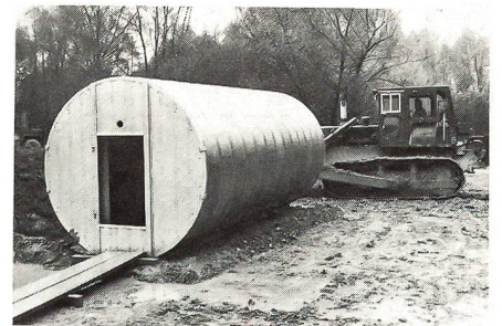
Ein für Feldbefestigungen geeigneter Unterstand aus Normelementen. Im Hintergrund eine schwere Baumaschine im Einsatz.
