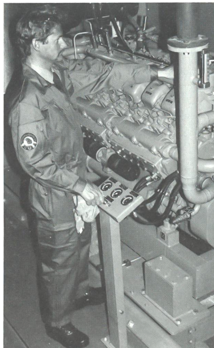
Kontrolle an einem Dieselmotor mit 12 Zylindern (210 kW) für eine Notstromgruppe einer Festungsanlage, Festungswächter in neuer Uniform.
