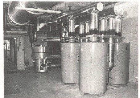
Die Frischluft passiert eine Filteranlage, bevor sie in die Anlage einströmt.
