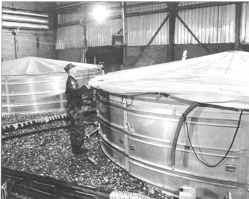
Blick in die Wasserhalle mit den Trinkwassertanks.
