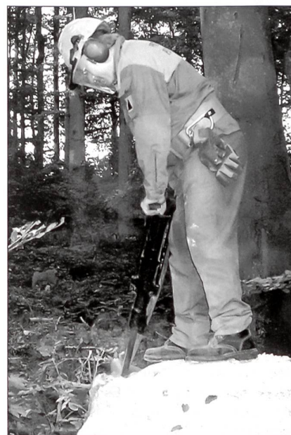
Kompressor. Im Gebiet Rothallen fühlen die Zivilschützer einer Panzersperre auf den Zahn.
