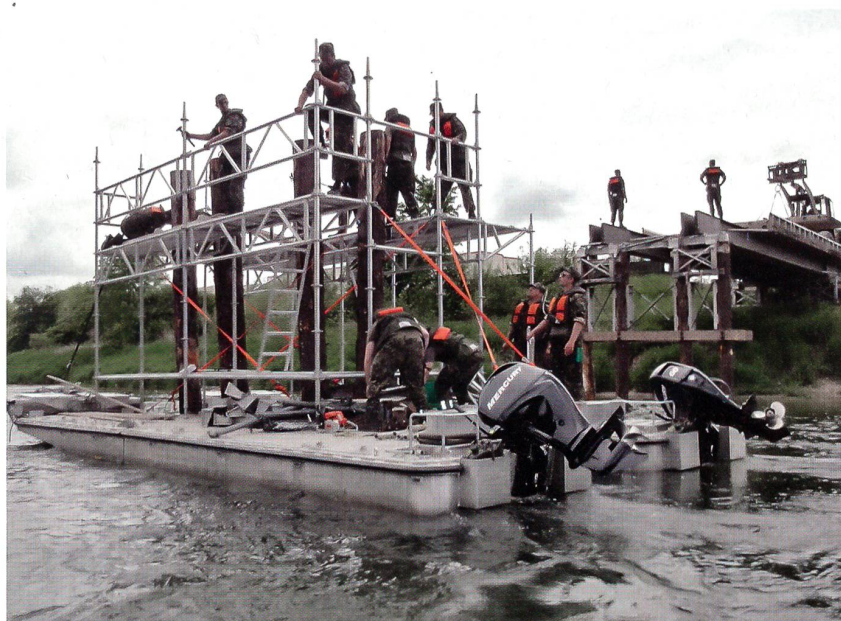
Amlikon: Soldaten des Katastrophenhilfebataillons 4 bauen eine behelfsmässige Brücke über die Thur. Die Tragkraft der Brücke beträgt stolze 70 Tonnen.
