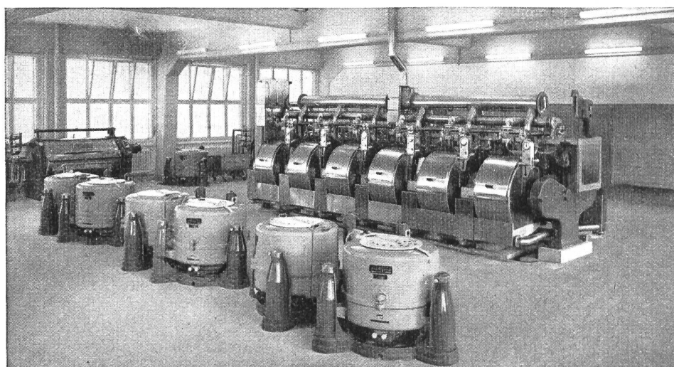
Wäschereianlage Kant.-Spital Winterthur
