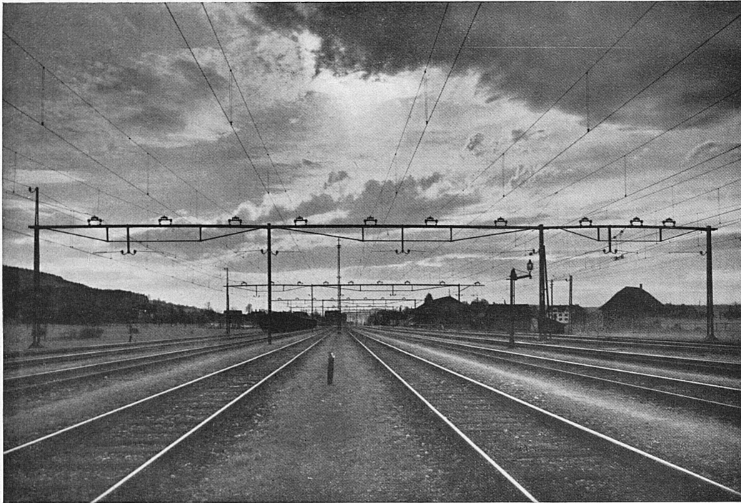
Lignes de contact dans une gare / Stationsfahrleitung
