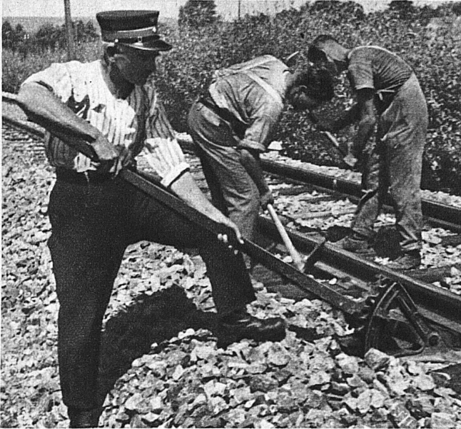
Das gelegte Geleise wird eingeschottert. Tragwinden heben die Stoßschwellen auf die richtige Höhe
