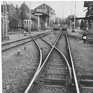
Vereinigte Bern-Worb-Bahnen. Der Eingang der Zunge besteht aus der normalen, alten Drehstuhlzunge, die an die anschließende Schiene angeschweißt worden ist.
