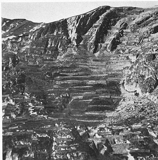
Rechts und rechts außen: Lawinenverbauungen auf Faldum ob Goppenstein an der Lötschberglinie. Photos: Schädelin, Schneiter
