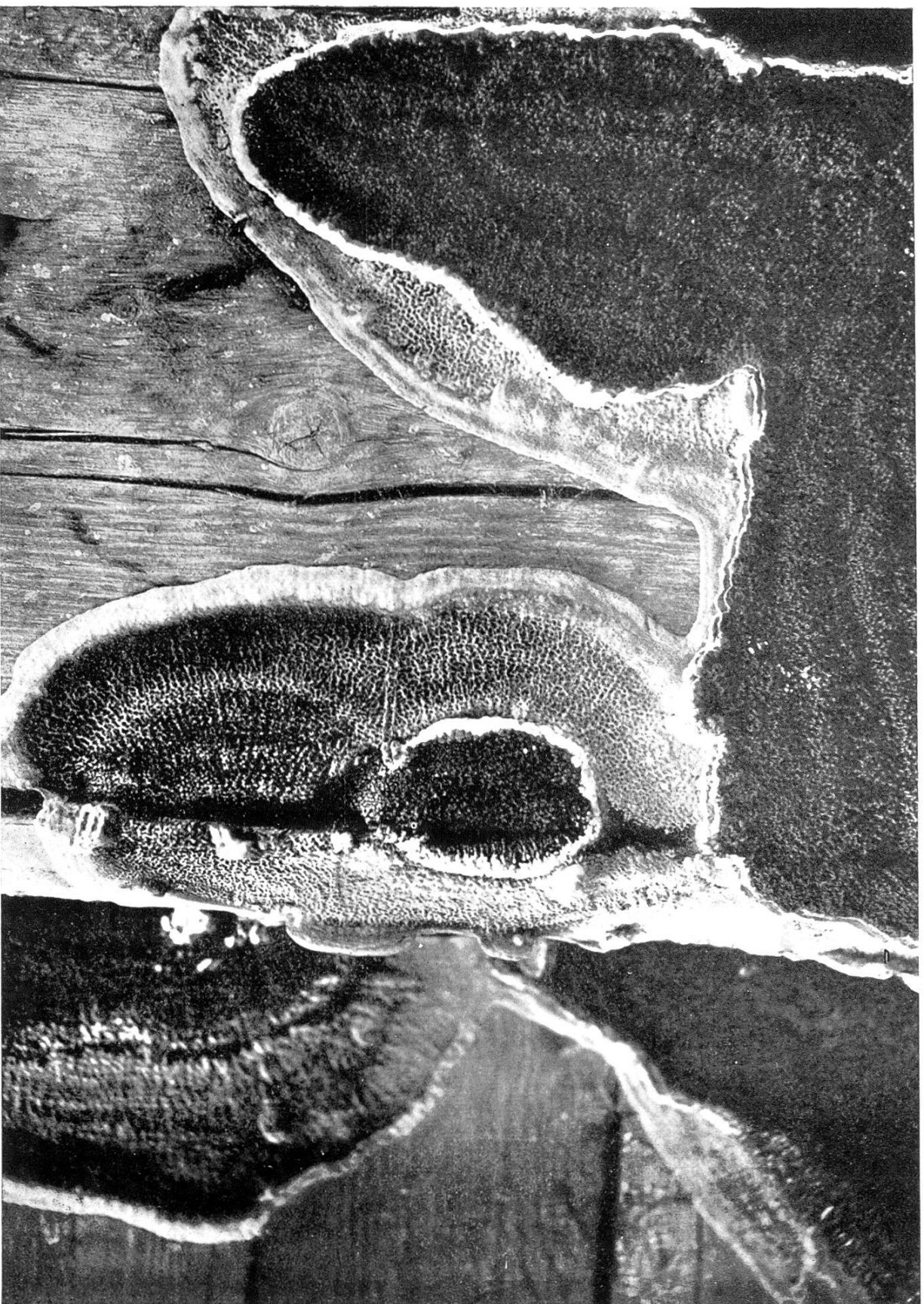
Fruchtkörper von Merulius domesticus (Salz) an einem Balken der Kellerdecke im Gartenhaus Möllisberg.
