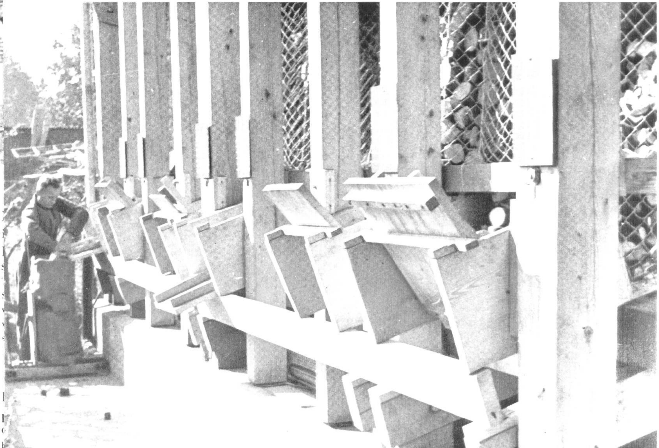
Bild 10. Siloausläufe mit Klappverschlüssen.
