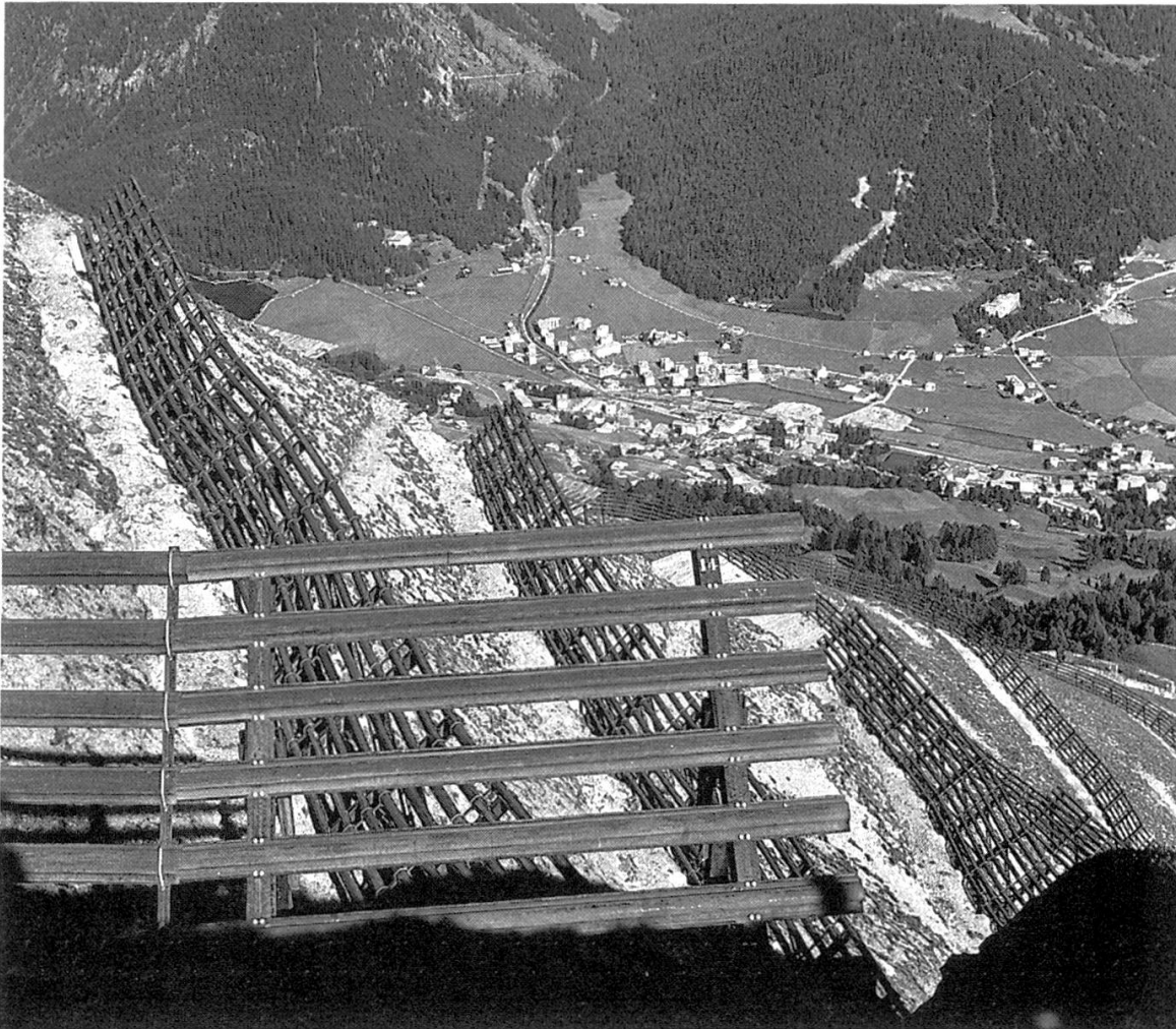
Abbildung 1. Stützverbauung (Schiahorn/Davos, GR).
