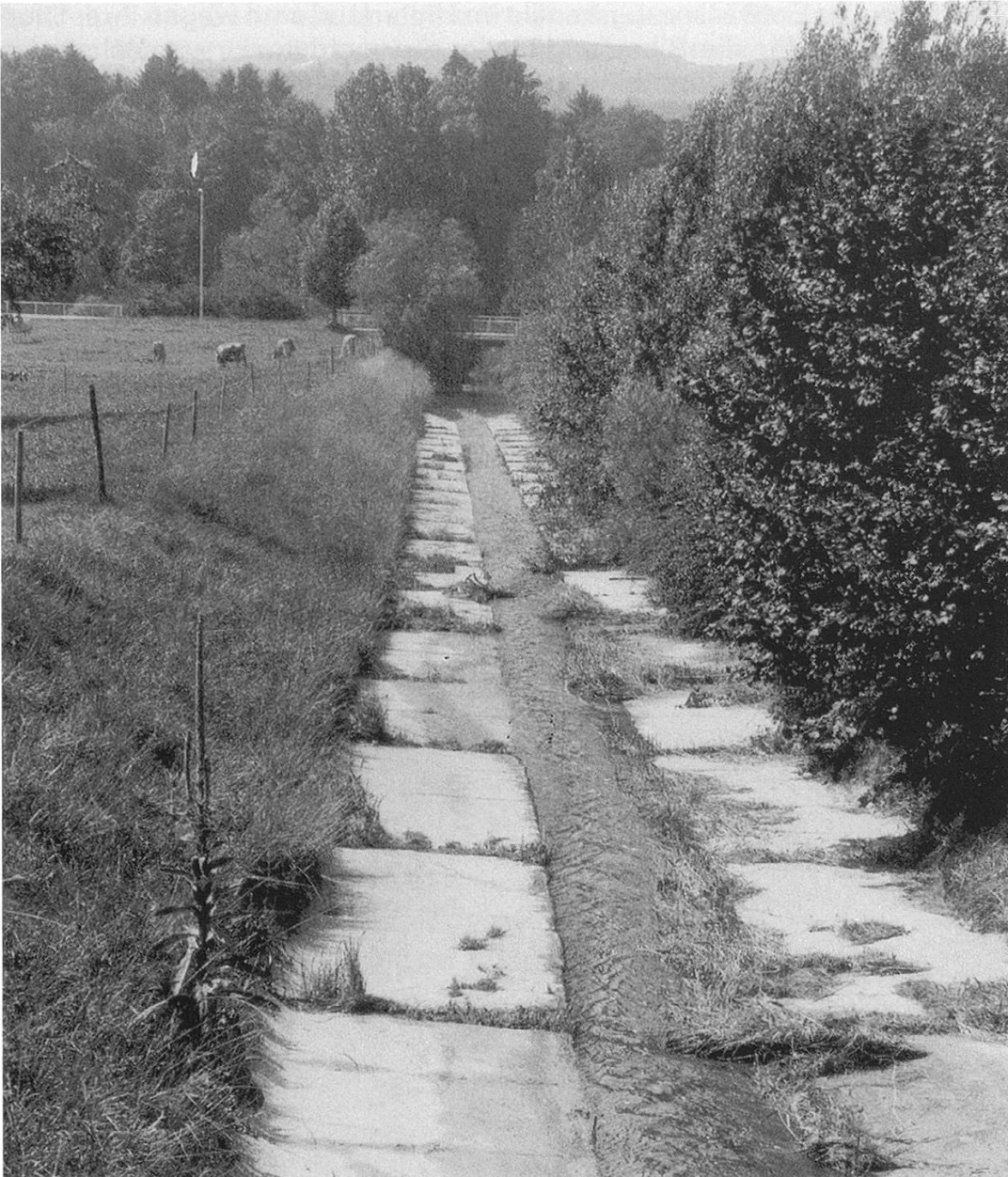
Abbildung 5: Ungeeigneter Biotop. Tobelbach südlich Müllheim mit seitlichen Betonplatten.
