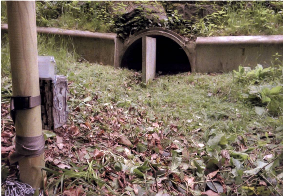
Abbildung 6: Beispiel der Installation einer Fotofalle (am linken Bildrand) vor einem Kleintierdurchlass (Standort Bernrain, Kreuzlingen). Foto: Kim Krause.
