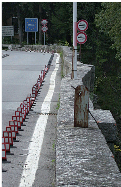
L'evidente degrado del vecchio parapetto.
