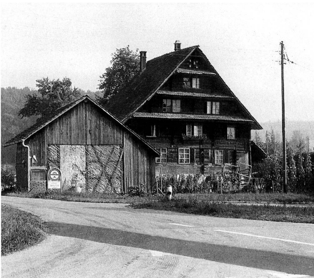
Abb. 13 Steinhausen. Haus Tann im Zustand des Zerfalls 1985.
