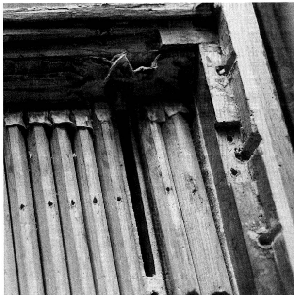
Abb. 104 Zustand der Windlade im Ventilkasten vor der Restaurierung.
