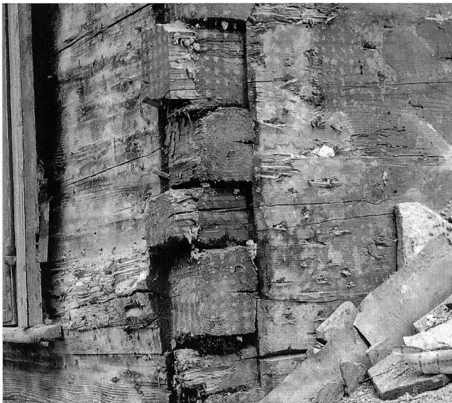
Abb. 12 Zug, St.-Oswalds-Gasse 16/18. Haus Nr. 16, Blick Richtung Südwesten auf die Nordostecke des Blockbaues. Nachträglich abgesägte Balken-vorstösse im 2. Obergeschoss.
