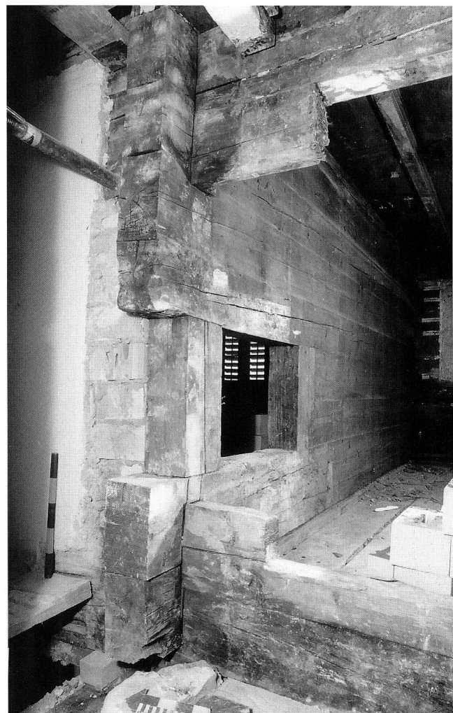
Abb. 14 Zug, St.-Oswalds-Gasse 16/18. Blick Richtung Nordosten in die Zimmer im 1. Obergeschoss, während der Untersuchungen 1993. Rechts der Blockwand der heutige Hausteil Nr. 18, links der Hausteil Nr. 16. Auf beiden Seiten der Aussparung stand einmal eine Ofenkonstruktion, die – wie die Abdrücke an der Blockwand erahnen lassen – vom Flur her beschickt wurde (grosse Wandöffnung rechts). Der profilierte Kopf des Balkens oberhalb der Wandöffnung belegt, dass dessen originales Ende nur wenig in den Nord-Süd-orientierten Flur des Blockbaues hineinragte. Die spätere Haustrennung in Nr. 16 und 18 nahm nur leicht versetzt die Flucht der zu sehenden Blockwand in West-Ost-Richtung auf. Länge der stehenden Messlatte 0,5 m.
