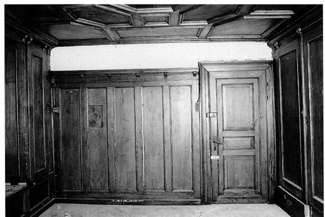
Abb. 21 Zug, St.-Oswalds-Gasse 16/18. Haus Nr. 16, Blick Richtung Süden in den Nordostraum des Erdgeschosses. Jüngere Täferausstattung.
