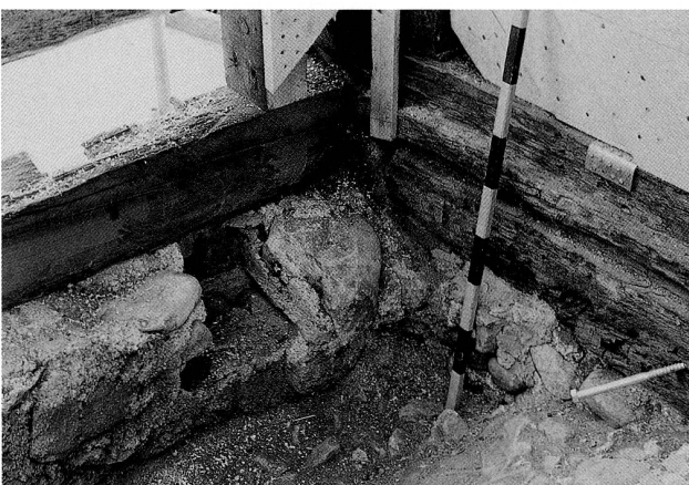
Abb. 5 Zug, Stolzengraben. Südwestzimmer im Erdgeschoss, Westecke. Auf der Krone der Südmauer (links) ist das Negativ eines Deckenbalkens der älteren Kellerdecke erhalten. Darin fand sich eine in Zürich geprägte Münze aus der Zeit um 1425. Rechts unten ist die Oberseite der Gewölbekalotte zu sehen.
