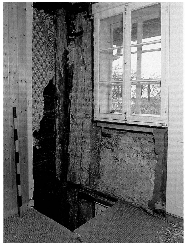
Abb. 12 Cham, Hünenbergerstrasse 43/45. Hausteil Nr. 45, erstes Obergeschoss, Trennwand zwischen beiden Gebäudeteilen. Blick Richtung Nordosten. Es ist deutlich zu erkennen, dass der Hausteil Nr. 45 (rechts) nachträglich an den Teil Nr. 43 (links) angebaut wurde.
