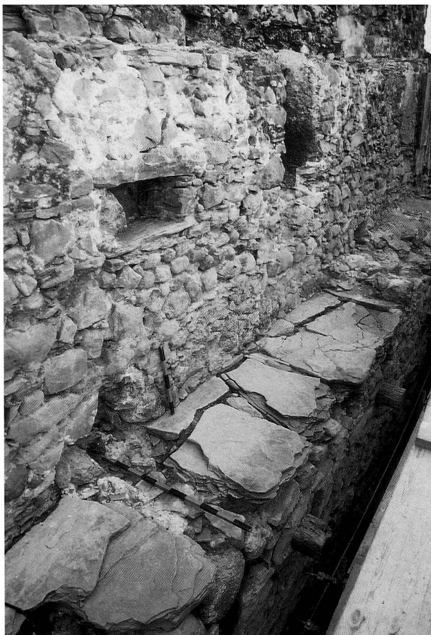
Abb. 17 Quartier Dorf. Innenseite der Stadtmauer auf der Höhe des Wehrganges, Blick Richtung Süden. Sandsteinplatten des ursprünglichen Gehhorizontes und waagrechte originale Schiessscharte. Im Bereich der liegenden Messlatte (Einteilung in Dezimeter) befindet sich der Ausbruch für einen Unterzug des jüngeren Holzaufbaus. Die Balkenköpfe unterhalb des Wehrganges stammen von neuzeitlichen Anbauten.
