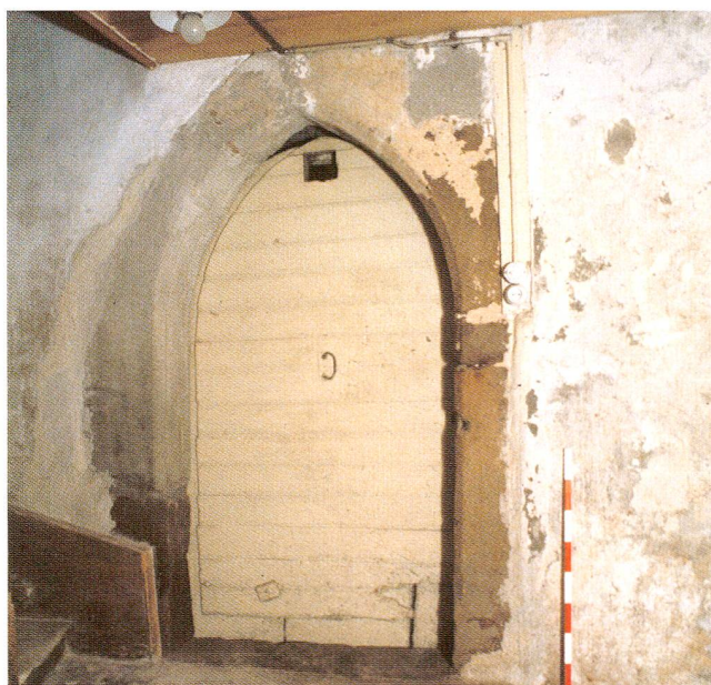
Abb. 36 Zug, Grabenstrasse 30. Portal des Kellerraumes, Blick nach Osten. Der gemauerte Keller im Ostteil des Erdgeschosses wurde nicht vor 1580 eingebaut.
