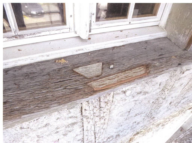
Abb. 10 Kloster Maria Opferung, Westfassade. Durch Metallhalterungen in der Fensterbank konnte Wasser eindringen und das Holz schädigen. Mit dem Stechbeitel wurde das zerstörte Holz soweit notwendig ausgenommen.
