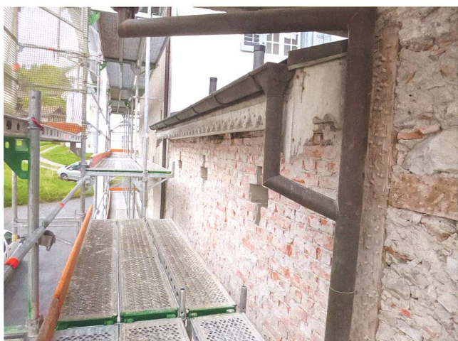
Abb. 7 Kloster Maria Opferung, Nordfassade. Baunaht.
