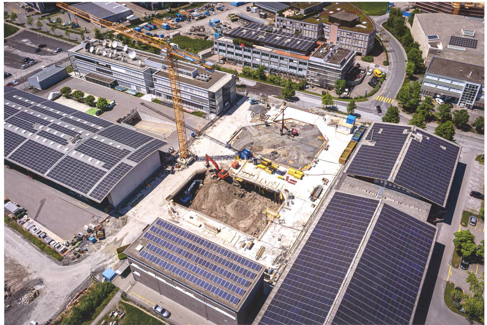
Abb. 18 Zug, Chollerstrasse 26. Bauperimeter kurz nach Aushubbeginn. Die Deckelplatte der Untergeschosse weist zwei grosse Öffnungen für die Aushubagger auf. Blick nach Nordwesten in Richtung Autobahn. Oben rechts noch knapp angeschnitten das Gebäude Erlenweg 5 im Rohbau; die Sumpfstrasse 18 befindet sich rund 100 m weiter links. Der Aufnahmestandort des Bildes befindet sich fast direkt über dem Lauf der Alten Lorze.
