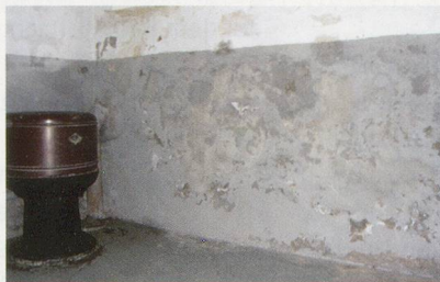
Schäden durch feuchte Mauern
