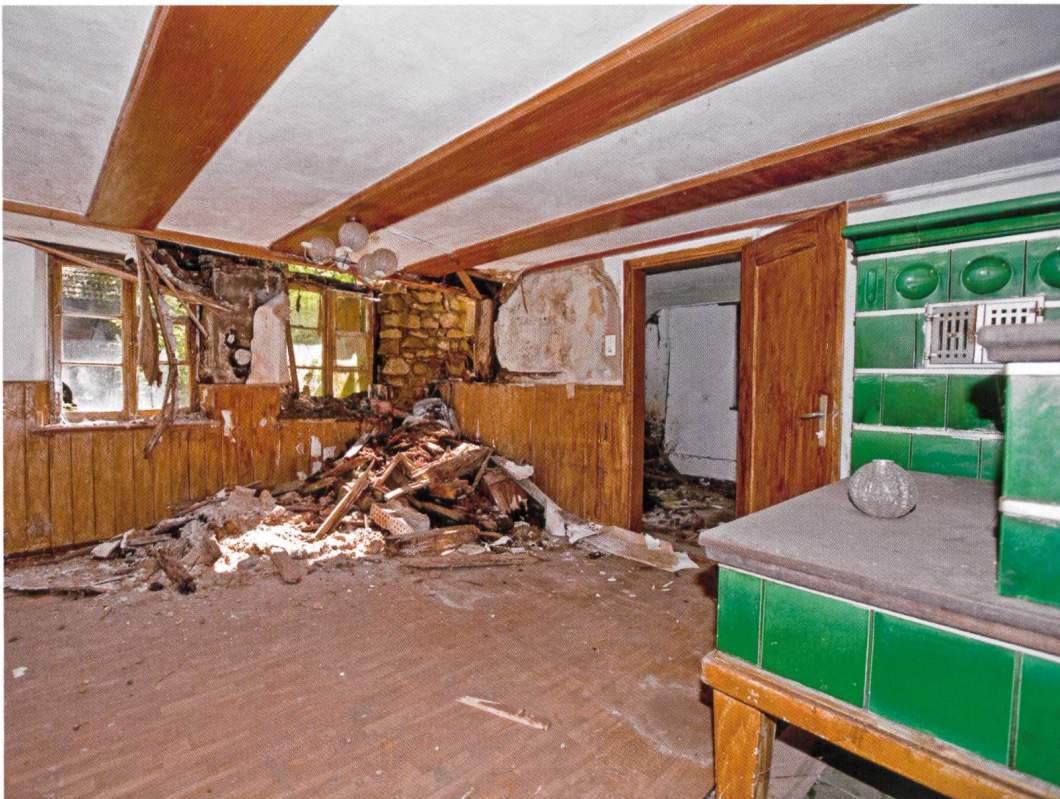
Abb. 9 Das Wohnzimmer mit der neuen Bruchsteinfassade aus dem 19. Jh. und dem modernisierten Kachelofen (Ansicht von Norden). Jahrelanger Wassereintritt durch das beschädigte Dach brachte in den letzten Jahrzehnten das Balkengerüst über dem Wohntrakt zum Einsturz.
