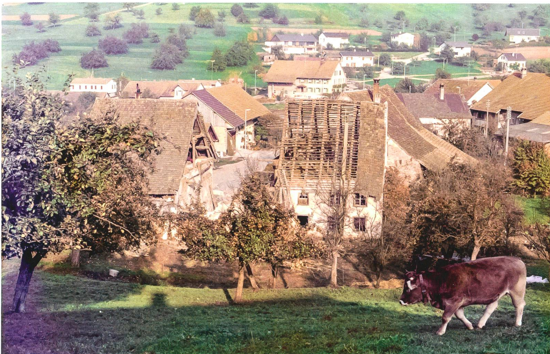
Abb.10 Oberherznach im Sommer 1975. Im Vordergrund der Abbruch des Hauses an der Kirchstrasse 5.
