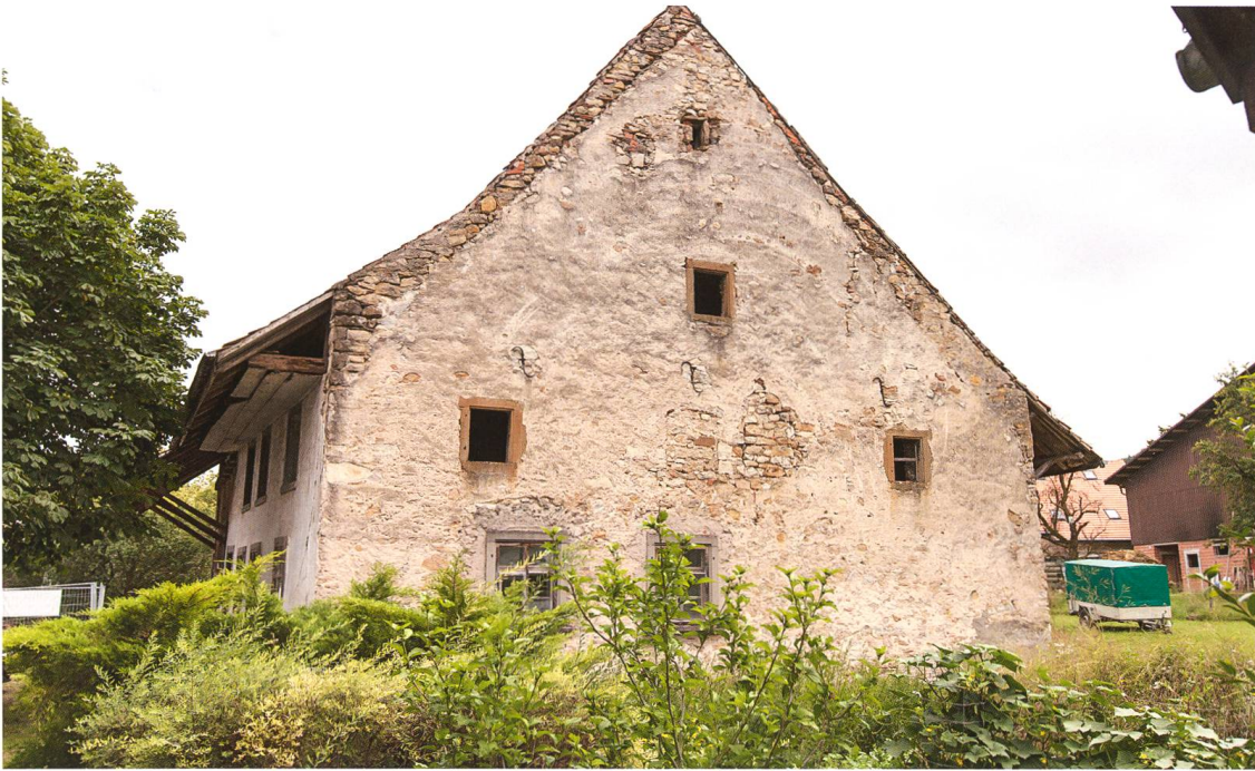
Abb. 7 Giebelwand M1, die wegen statischer Probleme an den Dachstuhl von 1808 d angepasst werden musste.
