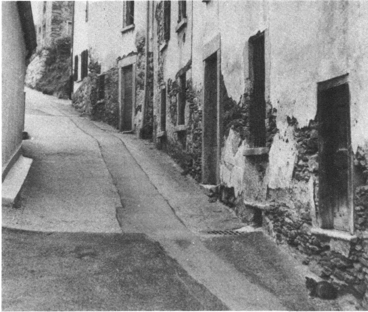
fig. 6 Dégradation du village par asphaltage et rafistolages répétés.
