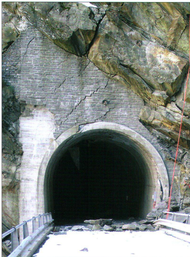
Fig. 8: Das Portal wird zerschert und verdrückt; wo das rechte Parament aufreisst, führt das Sammelkabel der Messgeber zum Datenlogger durch; trotzdem konnte bis 30 Minuten vor dem Absturz noch gemessen werden.
