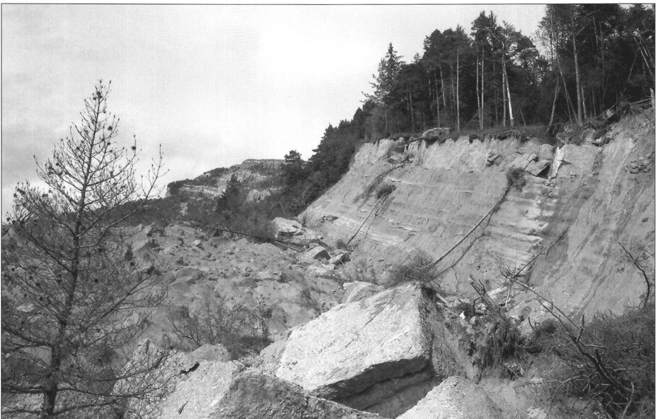
Fig. 6: Abbruchstelle der Felsrutschung vom 22. August 2005 bei Gribisch. An der Abbruchstelle sind die Mergel und Feinsandsteine überdurchschnittlich mächtig ausgebildet. Oben werden sie von einer etwa 3 m mächtigen, zerklüfteten Nagelfluhbank überlagert. Der Schichtstapel ist auf der gesamten Höhe des sichtbaren Abrissrandes abgerutscht. Die Gleitfläche befindet sich an der Basis der Mergel (stark verwitterte Mergelhaufen, links im Bild), an der Obergrenze eines darunter liegenden, etwa 20 m mächtigen Nagelfluhbandes. Im Hintergrund ist die Gipfelpartie des Gnipen zu erkennen (Foto September 2006).
