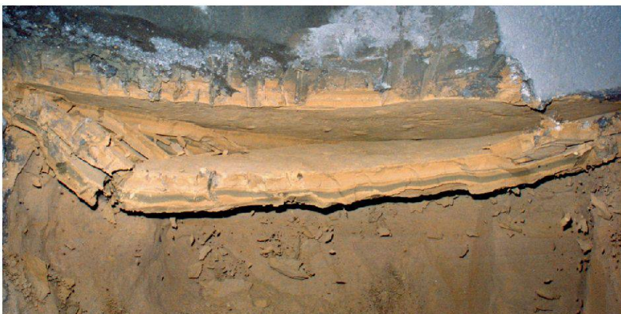
Fig. 6: Grenzbereich eiszeitliche Seebodenlehme/Sandlage; Verhalten des Lockergesteins beim Ausbruch der Sandlage [spontane, plattenartige Niederbrüche der Seebodenlehme innert einiger Minuten], Bildhöhe circa 1 m [Foto S. Frank].
