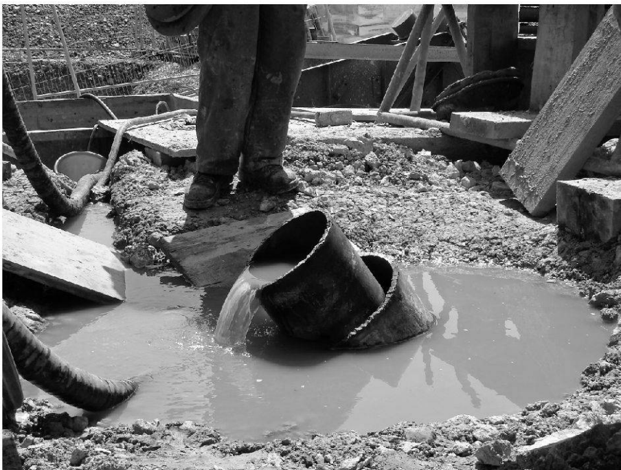
Fig. 8: Venue d'eau artésienne sortant du tubage 9"5/8.
