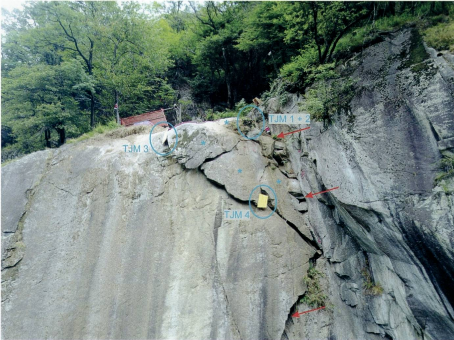
Fig. 3: Detailaufnahme der instabilen Felsplatten (nach Entfernung der Lockergesteinsüberdeckung): Die roten Pfeile zeigen die Lage der offenen Hauptkluft im Süden des grossen massigen Felskompartimentes (links). Die blauen Kreise weisen auf die Lage und Nummern der Telejointmeter (TJM) hin. Mit den Sternen sind die vier wichtigsten instabilen Felsplatten bezeichnet.
