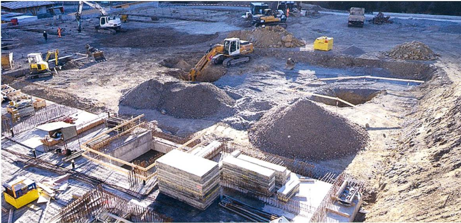
Fig. 12: Freigelegte Karsthohlräume in der zweiten Untersuchungsetappe. Davor der angelieferte Kiessand zur Verfüllung und Verdichtung (Bild Th. Rüegg, 03.11.2017).
