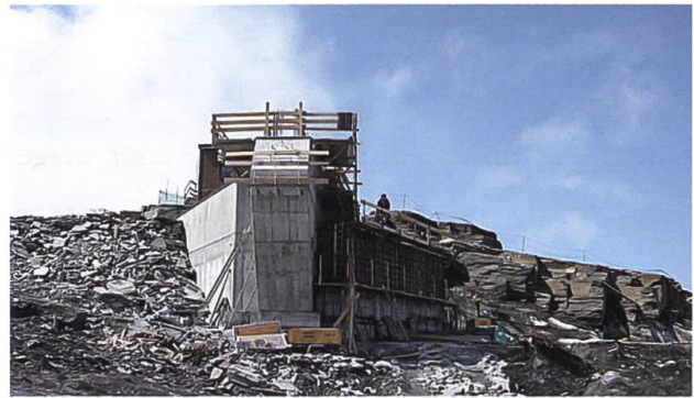
Fig. 4: Ansicht der Fundamente im Bauzustand; Blick von Norden auf den vorderen Steher.
