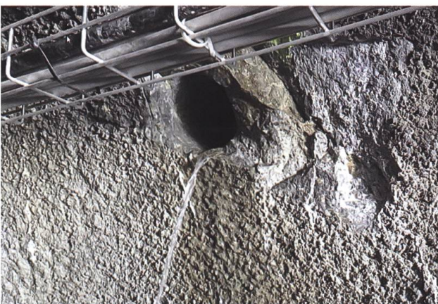
Fig. 10: Wasserführende Entlastungsbohrung im Spritzbetongewölbe des Aletschanges.
