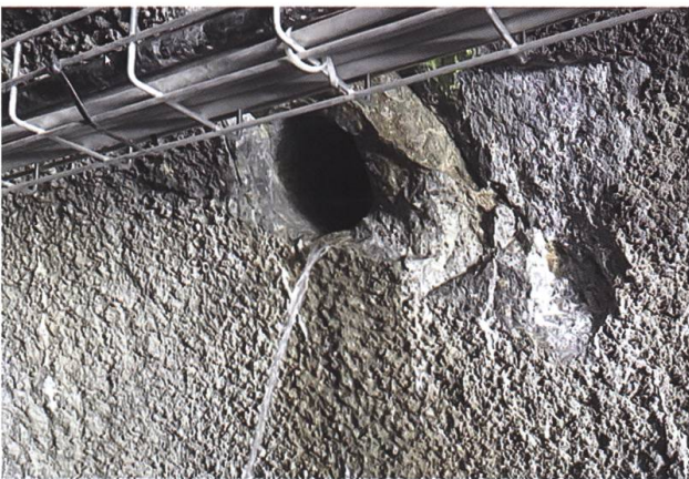
Fig. 10: Wasserführende Entlastungsbohrung im Spritzbetongewölbe des Aletschanges.
