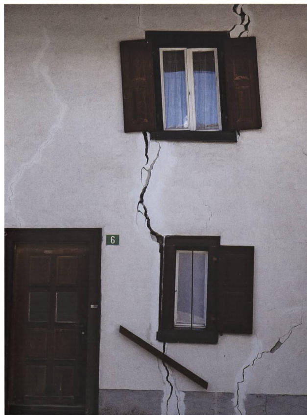
Fig. 10: Eines der stark beschädigten Häuser auf der Rutschung Dorf, welches mittlerweile abgerissen wurde. Foto Christoph Nänni, TBA GR.
