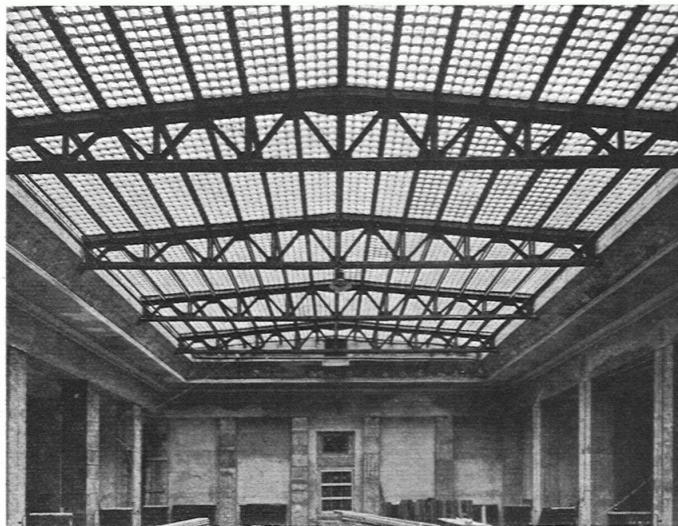
Abb. 2. Untersicht des Keppler-Glasbetondaches über der Kassenhalle der Schweiz. Volksbank in Zürich, 200 m 2 .
