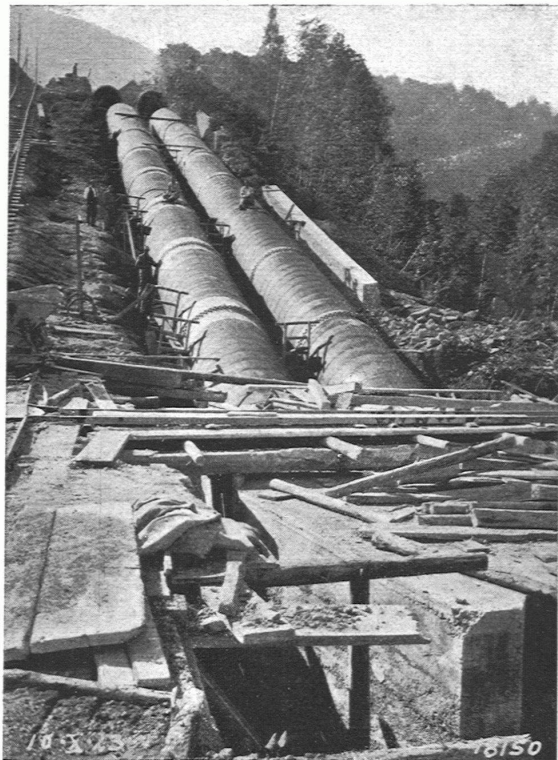
Abb. 2. Sulzer-Druckleitungen von 2500/2200 mm Durchmesser und 816 m Länge bei 195 m Gefälle vom Rempen-Staubecken zur Zentrale Siebnen.
