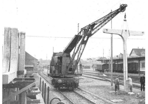
Transport und Montage der Elemente | Transport et montage des éléments | Transport and erection of the units
