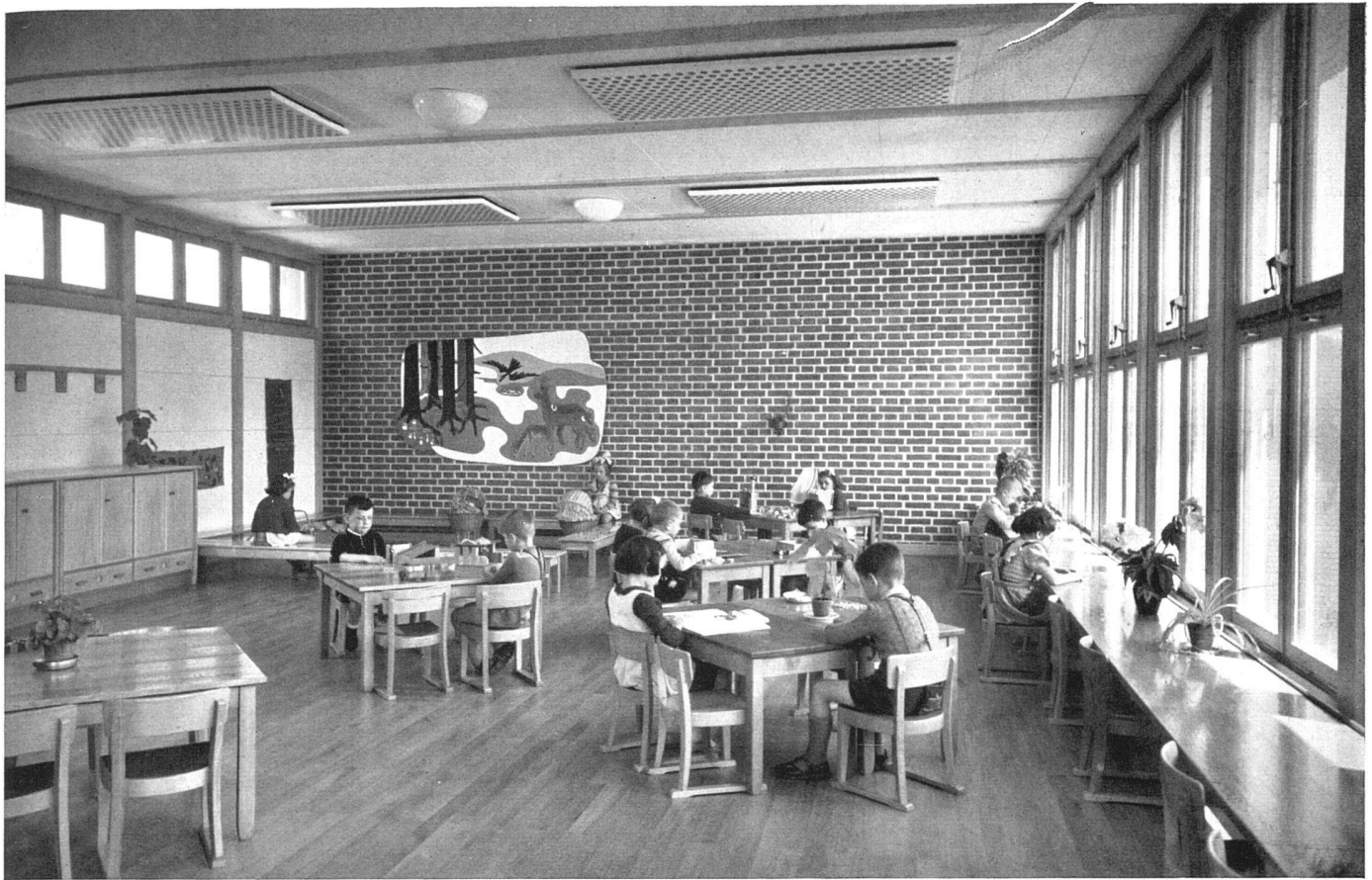
Kindergartenlokal; an der Decke elektrische Heizelemente | L'intérieur de la crèche; chauffage électrique par panneaux fixés au plafond | Interior, electric panel heating on ceiling
