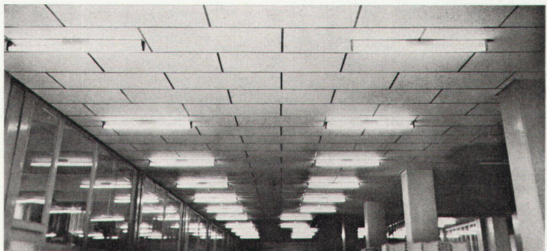
ungelochte Schallschluckplatte, unbrennbar, hier mit sichtbarem Hängergrost in einem Druckereisal
