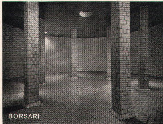
Flughafen-Immobilien-Gesellschaft Zürich-Kloten 7 Tanks total 5600 m 3 Schweröl
