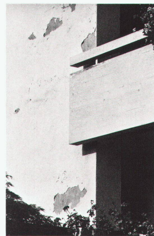
Schadensbild vor der Sanierung
