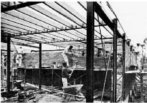
Craig Ellwoods Case Study House #17 (Beverly Hills, 1954–55) im Bau. Bild aus: H. Singerman (Hrsg.), Blueprints for Modern Living, Museum of Contemporary Art, Los Angeles 1989.
